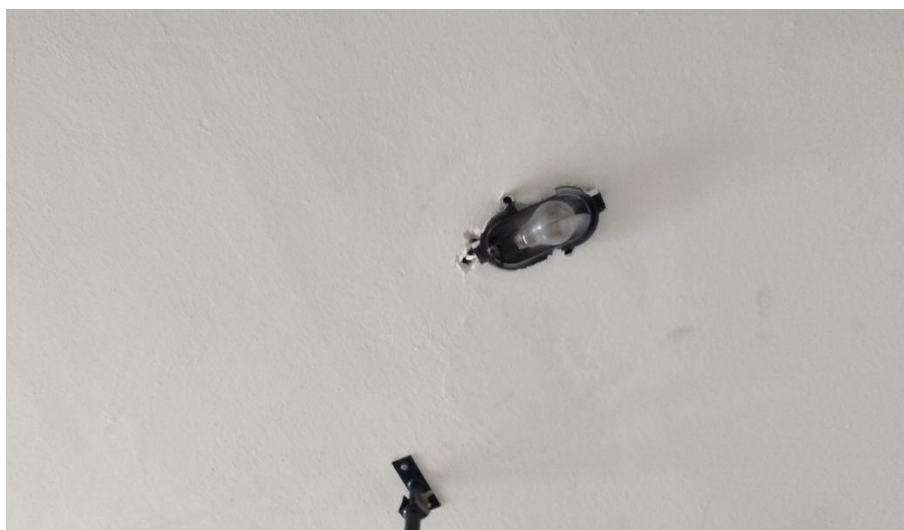
Τα υφιστάμενα φωτιστικά σώματα του σχολείου (Τύπος Β)
