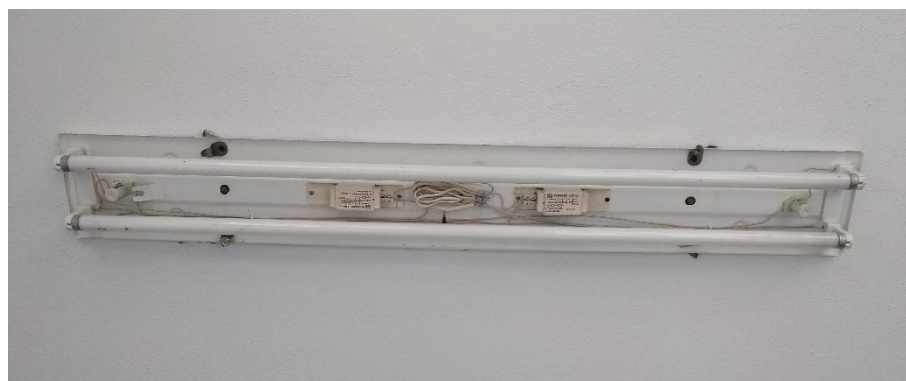
Τα υφιστάμενα φωτιστικά σώματα του σχολείου (Τύπος Α)
